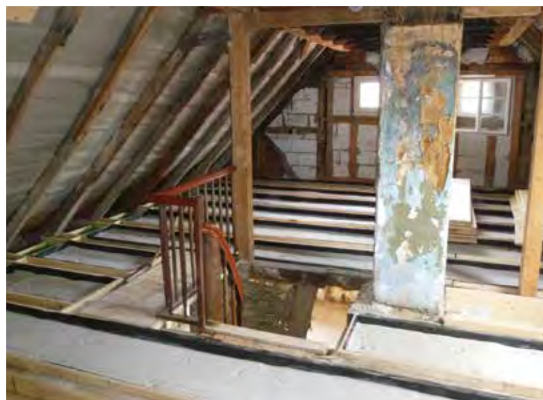
Der unsanierte Dachstuhl im Geburtshaus von Wilhelm C. Röntgen in Lennepe, erbaut nach 1783. Ein Fall für Werner Zultner und sein Team.
