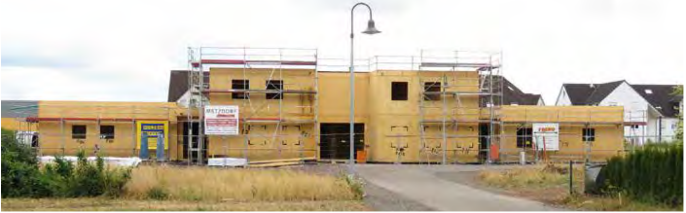
Aus 290 cbm Brettsper Holzdecken und 190 cbm Brettsper Holzwänden wurden wunderbare Räumlichkeiten für über 150 Kinder errichtet.
