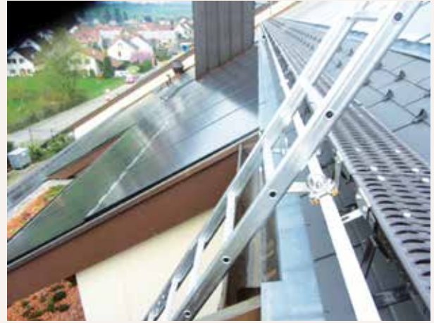
Beispiel Anlegeleiter: Aufstieg zum Steildach mit Photovoltaik-elementen mittels Anstelleiter
