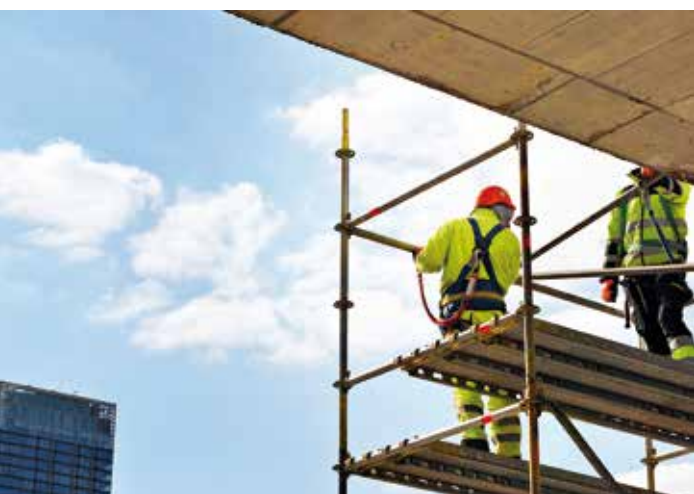
Fehlt der Seitenschutz, ist die Nutzung von PSAgA angezeigt (Auffanggurt, Verbindungsmittel und Helm mit Kinnriemen).
