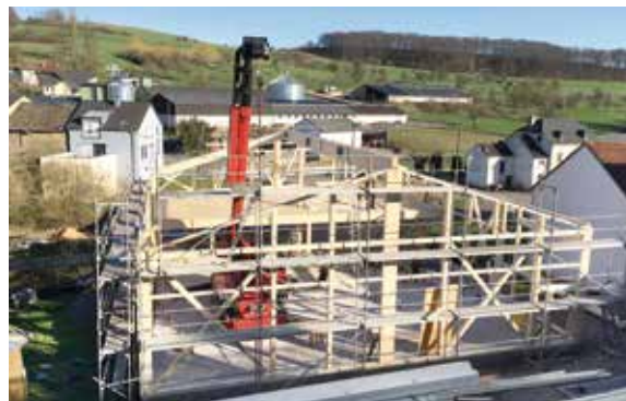
Mit Hilfe eines Krans wurden die vorgefertigten Holzbalken ins Innere der Halle transportiert.
