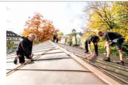
Hier installieren die Mitarbeiter gerade die Schneefänge in gleicher Farbe und ebenfalls aus Kupfer.
