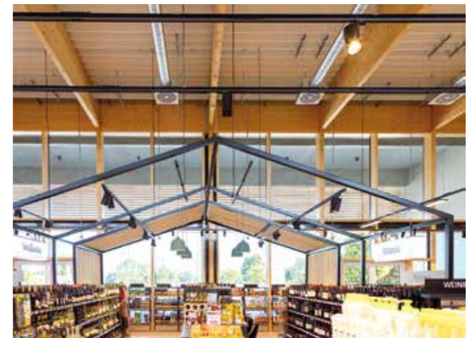
Innensicht: Insgesamt erstellte der Betrieb rund 5400 Quadratmeter Flachdach aus Trapezblechen auf Brettschichtholz.
