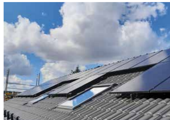
Die PV-Anlage erbringt eine Höchstleistung von 8,88 kWp mit einem Eigenverbrauchsanteil von 44,8 Prozent und einem sehr hohen Autarkiegrad von 72,9 Prozent.
