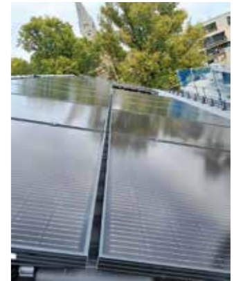
Aurnhammer kooperiert mit einem Elektrobetrieb, um den Kunden eine PV-Anlage aus einer Hand anbieten zu können.
