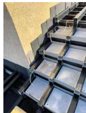
Die Unterkonstruktion für die Treppe direkt an der Wand stellte eine Herausforderung dar.
