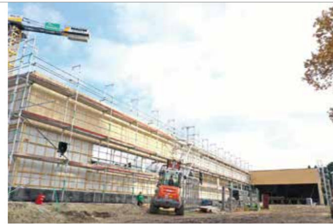
Auf die doppelschaligen, gedämmten Wände wird das Grundgerüst montiert, als Basis für die Lärchenholzfassade.
