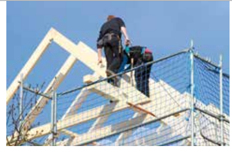
Fangnetze verhindern den Absturz aus großer Höhe.
