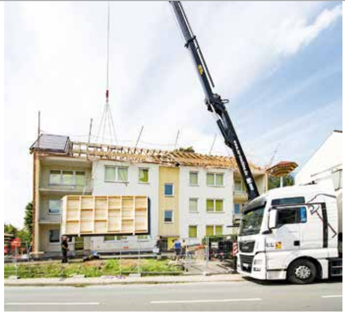
Dach und Hauswand können gleichzeitig mit einem im besten Falle direkt aufeinander abgestimmten Modulsystem eines Herstellers saniert werden.
