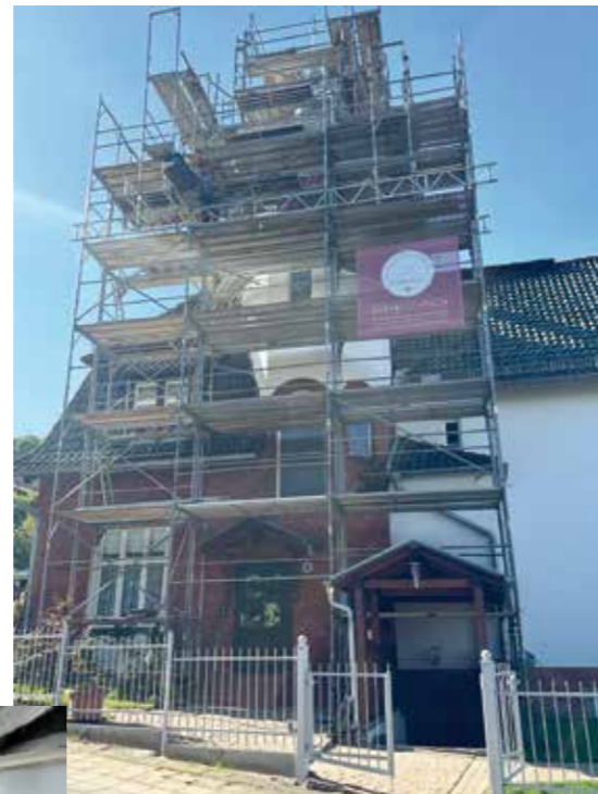
Jede Dachschindel ist ein Unikat. Ein Mitarbeiter bei der Arbeit am voll eingerüsteten Turm.
