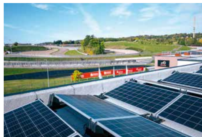
Auch auf dem eigenen Firmensitz direkt am Sachsenring wurde eine PV-Anlage installiert.
