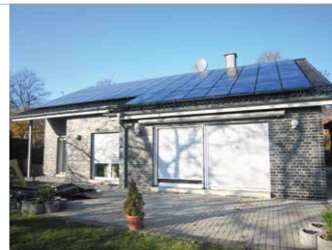
Klassisches PV-Geschäft: ein privates Einfamilienhaus.
